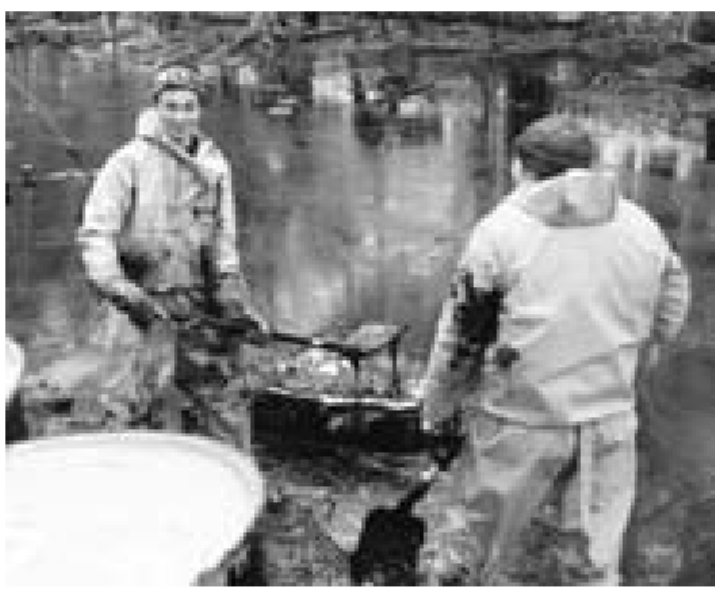
Росрыболовства не согласованы размещение котлованов вдоль трубопровода и слив в них нефтепродуктов и жидкости. Не давали таких разрешений также Печорский комитет по охране окружающей среды и Комитет лесов по Коми. Пробой воды, отобранной в реке Ылжит Каменка и в ручье Войвож - правого притока реки Марьель, расположенных вблизи места размещения слитой нефти, показали, что содержание нефтепродуктов в 70 раз превышало допустимые пределы.
