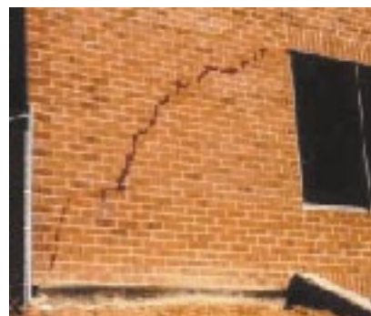
Рис. 2. Деформация гражданского здания после набухания глинистых пород основания
